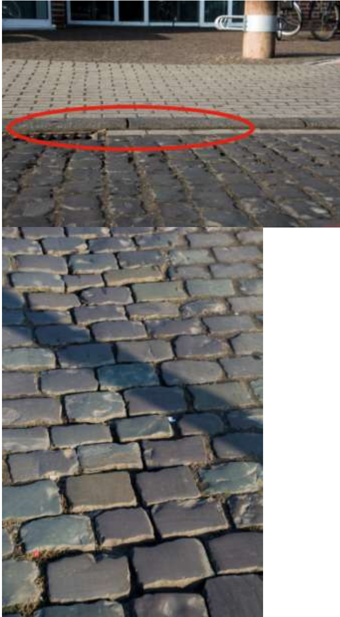
Beseitigung der Stolperkante und der großen Zwischenräume am Fußgängerüberweg Alte Dinslakener Str.
